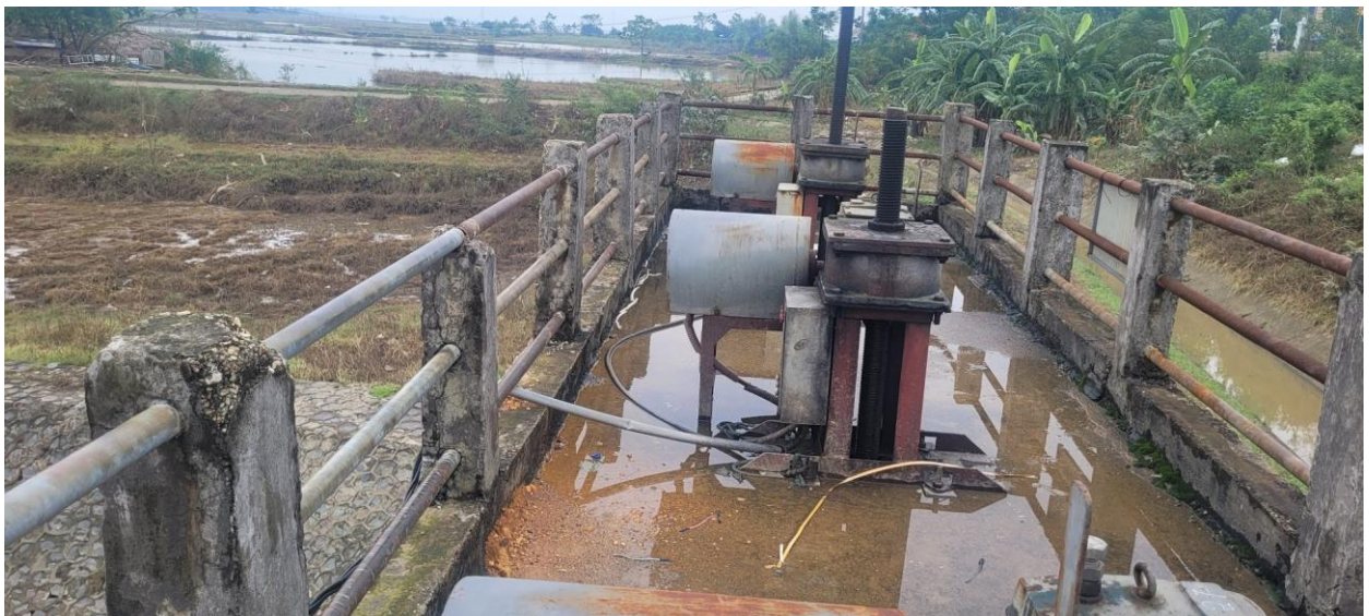
Hình 2: Sàn vận hành hư hỏng, hệ thống lan can hư hỏng, xuống cấp
