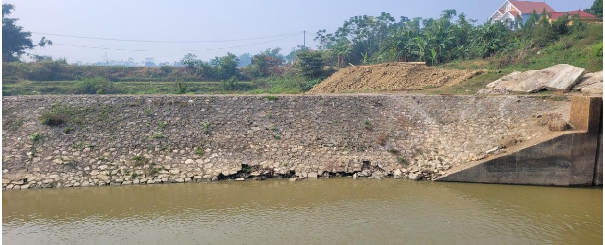
Hình 3: Mái bê tiêu năng bị vỡ
