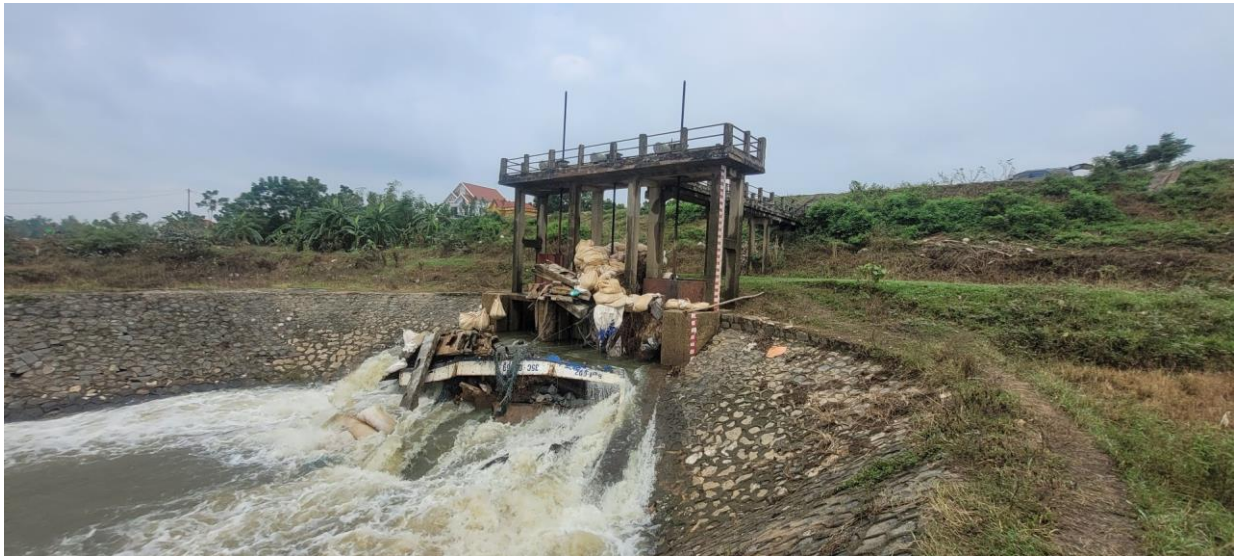
Hình 1: Khoang vận hành hư hỏng, cánh van bị bục
